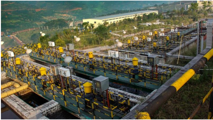
彝良驰宏选矿废水处理系统
