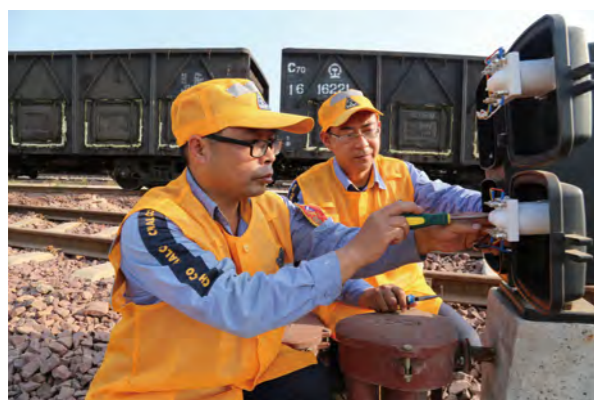
中铝物流中部陆港通信班员工在铁路专用线检测信号机
